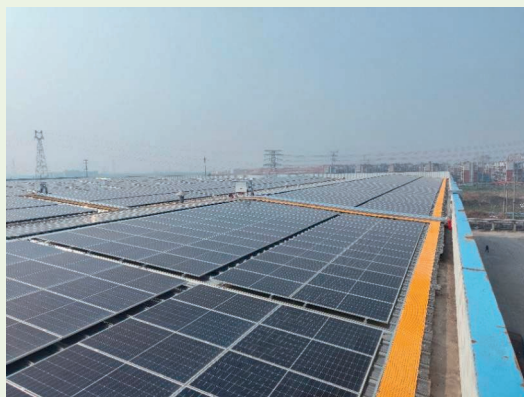
圖：江蘇甬金分佈式光伏電站
