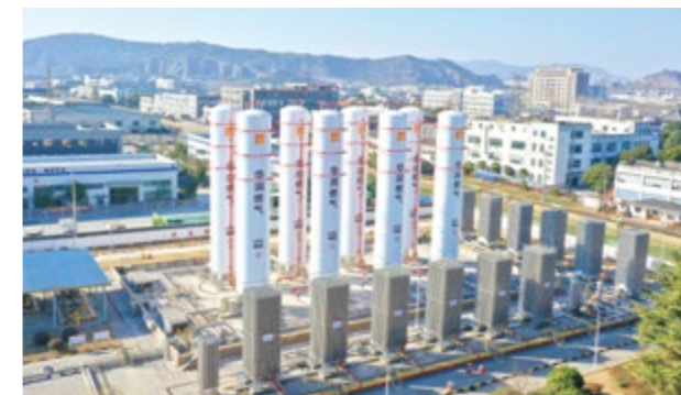
苏州公司LNG应急调峰站
